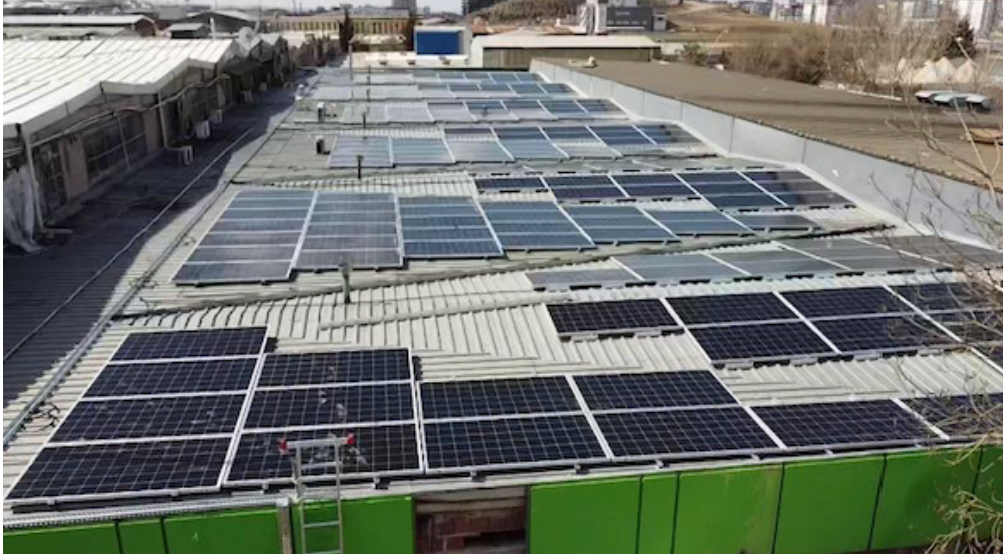
OSTİM YATIRIM A.Ş. 17084 Ada 7 parsel Çatı GES Projesi
